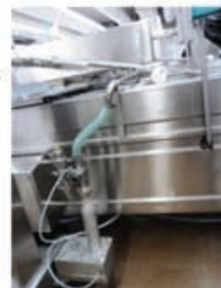
3. Dysze Airspexx zainstalowane w maszynie pakującej
